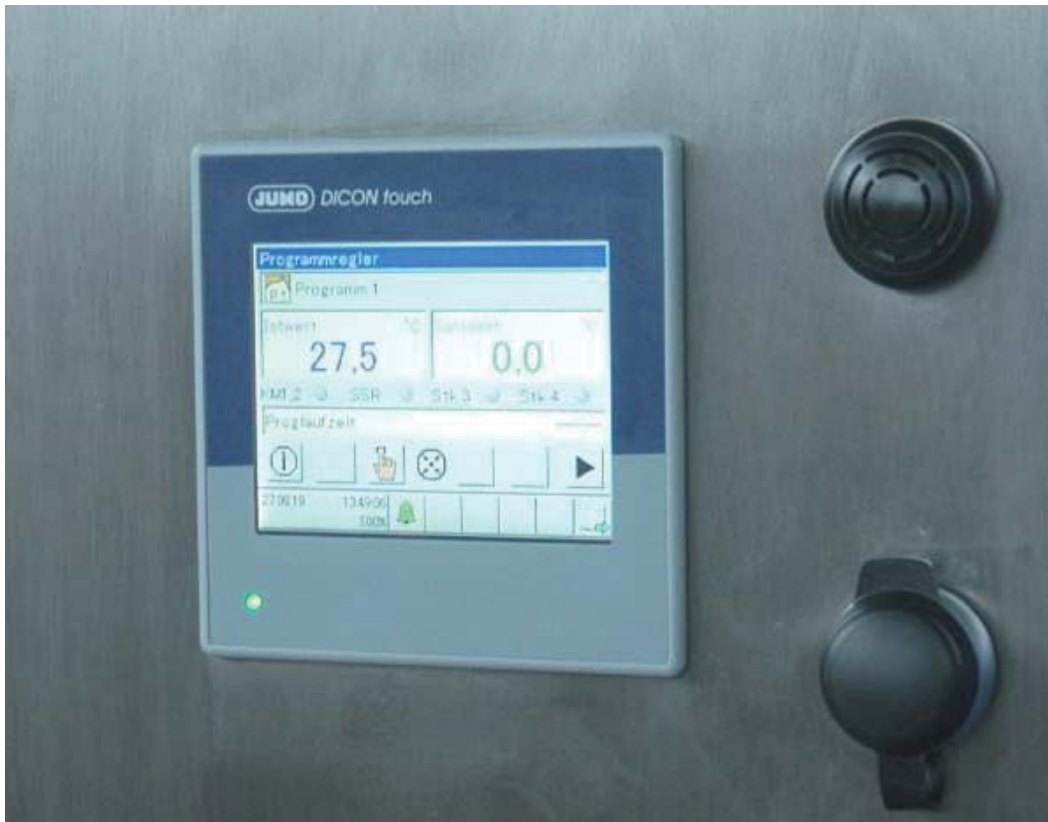
Panel de construcción - nivel de operador
